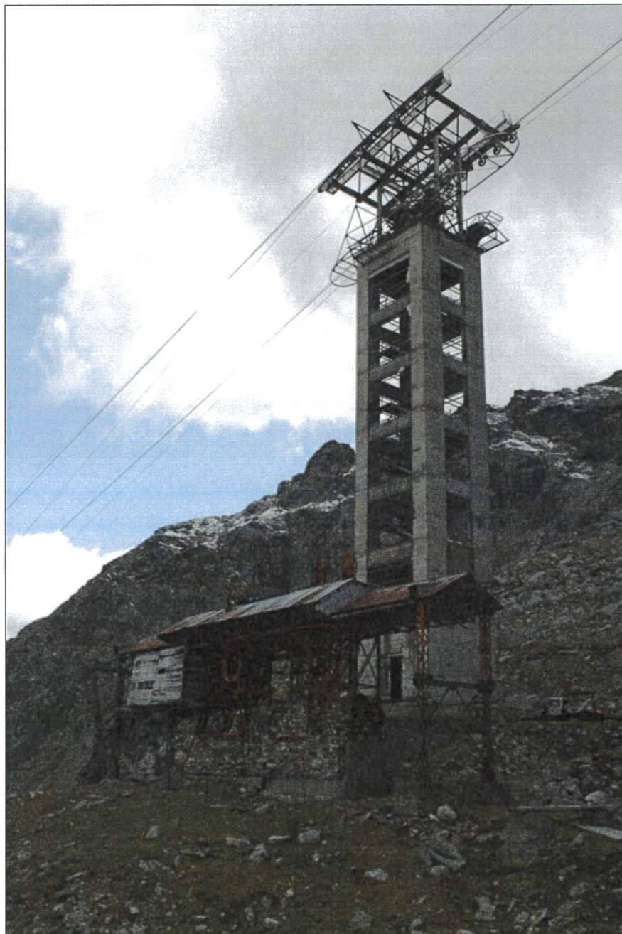
Sostegno 2 - Vista lati est e nord. In primo piano la teleferica di prevista demolizione.
